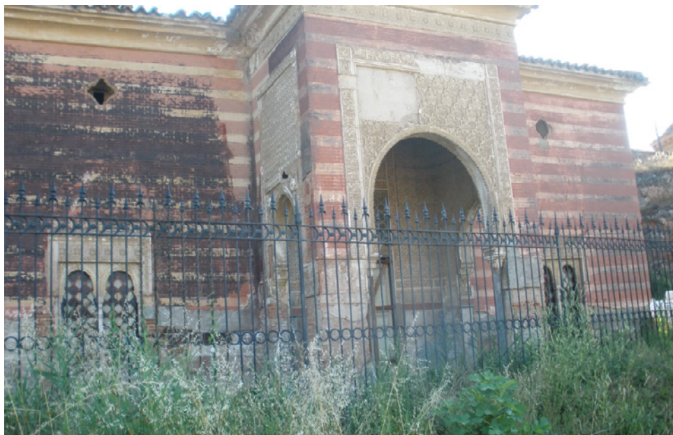
Estado actual de los Baños del Rey, fotografía de Eduardo Serrano.
